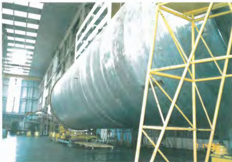
写真 2 4 燃料タンク 直径 8 m，長さ 3 2 m
